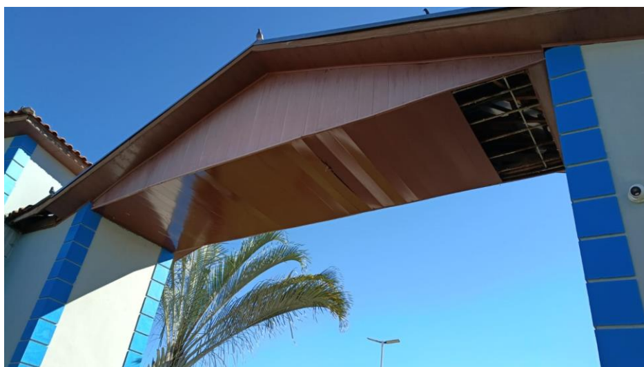
Figura 1 – Vista do forro danificado no Portal da Cidade.
