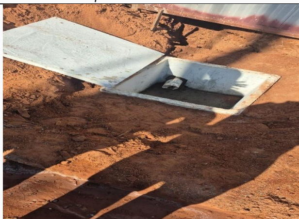
Foto 28 – caixas esgoto inspeção.
